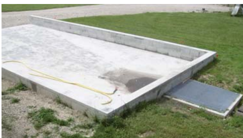
Photo : aire de lavage balayeuse
